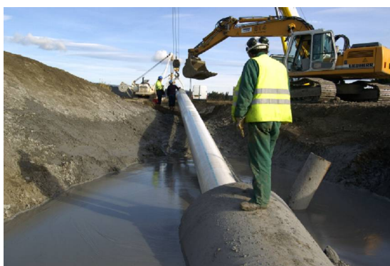
Canalisation dans le tubage de DN1500 mm
